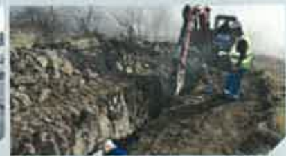
Axe Saint-Paul en Jarez à Bourg-Argental longueur de fibre déployée : 38 km dont : • 6,7 km en aérien sur lignes électriques basse et moyenne tension • 10 km en souterrain (couverture de tranchées) • 8,4 km dans des ouvrages existants de France Télécom Orange • 11 km hors de l'axe de collecte existant desservant des zones d'activités ou autres.
