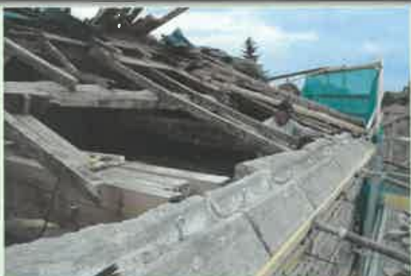
Réalignement des éléments de corniche avant pose de goujons inox et consolidation à la chaux
