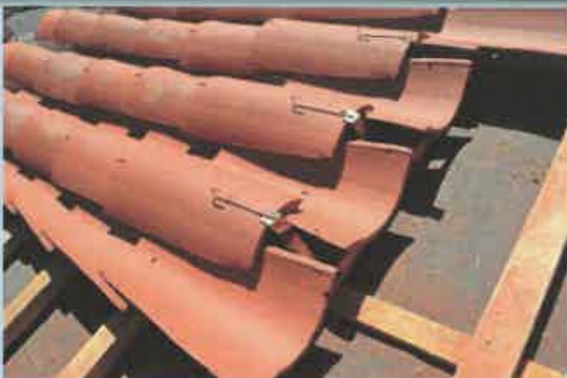
Détail de crochetage des tuiles chapeau (bande de cuivre rapportée sur liteau)
